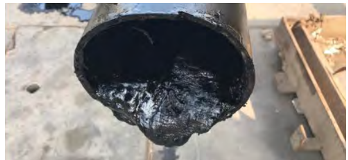
Bei Mineralölen sammeln sich lose Kohlenstoffpartikel in tiefer gelegenen Bereichen einer Anlage und verursachen Schlamm.
